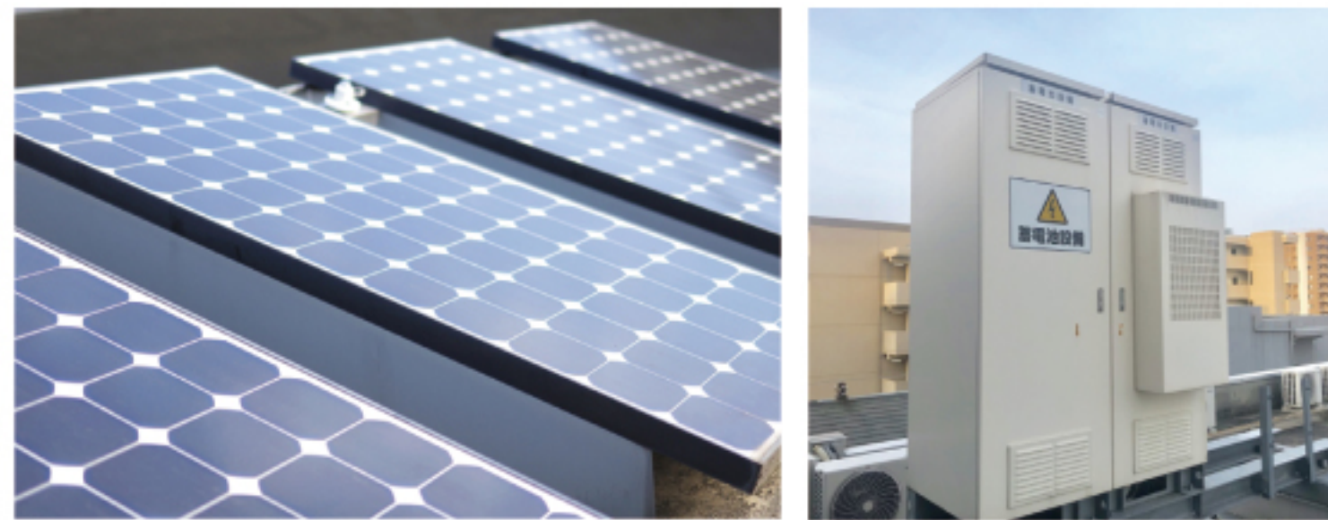
太陽光パネルを屋根上に設置し9Fに蓄電池を配置
